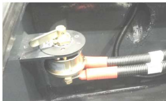
Рисунок 2-13. Выключатель аккумуляторной батареи
